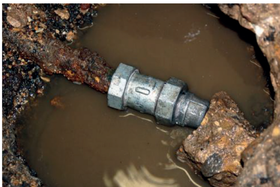
FIGURA 4.9 Fuga en la red de distribución
