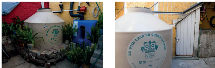
FIGURA 4.14 SCALL instalados en la CDMX
