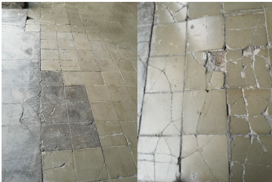
Ilustración 13. Daños en el piso de mosaico de pasta de cemento por abombamiento del terreno. Fotografías del autor.
