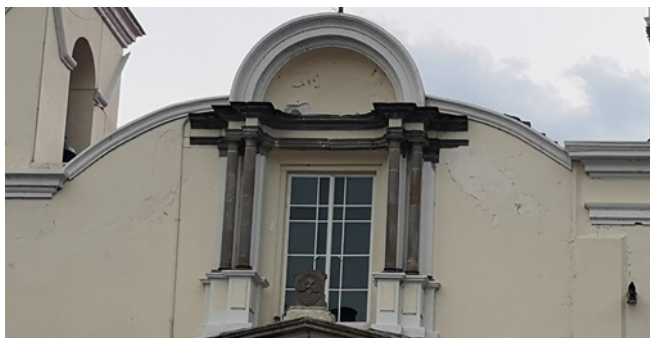
Ilustración 3. La pintura dañada nos permite ver las juntas frías a cada lado de la ventana coral. Fotografía del autor.
