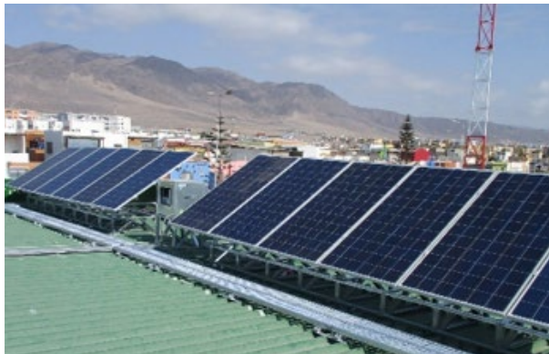
Fig. 5. Instalación fotovoltaica en cubierta de Edificio de salud con certificación CES
