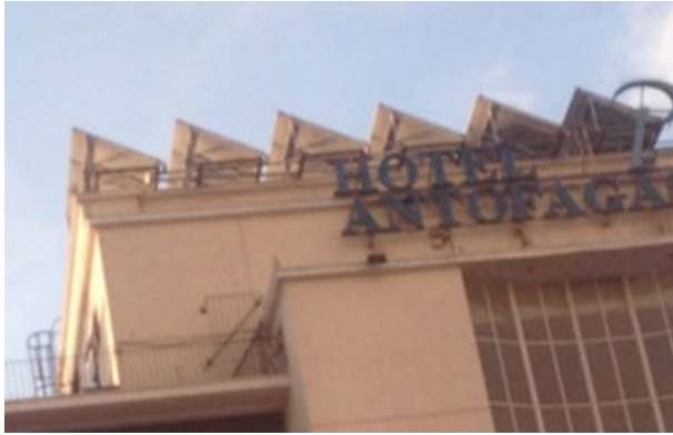
Fig. 6. Rehabilitación energética Instalación fotovoltaica en cubierta de Hotel Antofagasta
