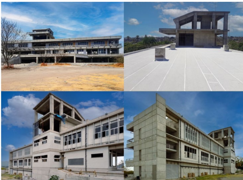
Figura 22. Vistas del avance en la construcción del edificio E1, de izquierda a derecha: a) fachada sur, b) vista este de la azotea; c) vista noroeste; d) vista noreste
