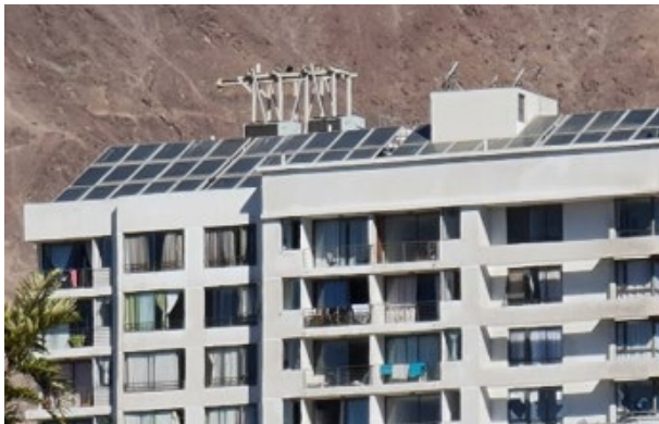
Fig. 7. Instalación fotovoltaica en cubierta Edificio Habitacional nueva construcción
